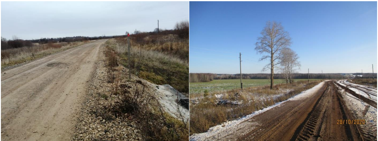
1) Дорога «Нема-Колобово», контракт на строительство которой предусматривал асфальтобетонное покрытие; 2) Дорога «Зуевка-Октябрьский-Городище», контракт на капремонт расторгнут из-за некачественного проекта
