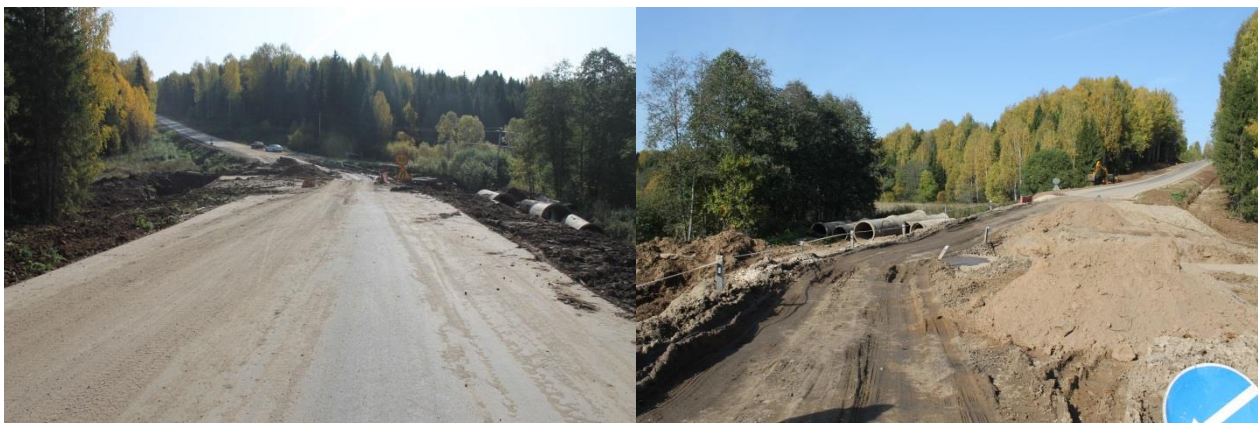
Капитальный ремонт дороги «Среднеивкино-Воронье» (стоимость 191 млн. руб.) к установленному сроку 01.10.2020 не завершён
